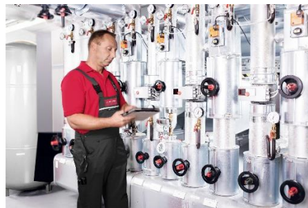
Dussmann Facility Management: Gebäudetechnik
